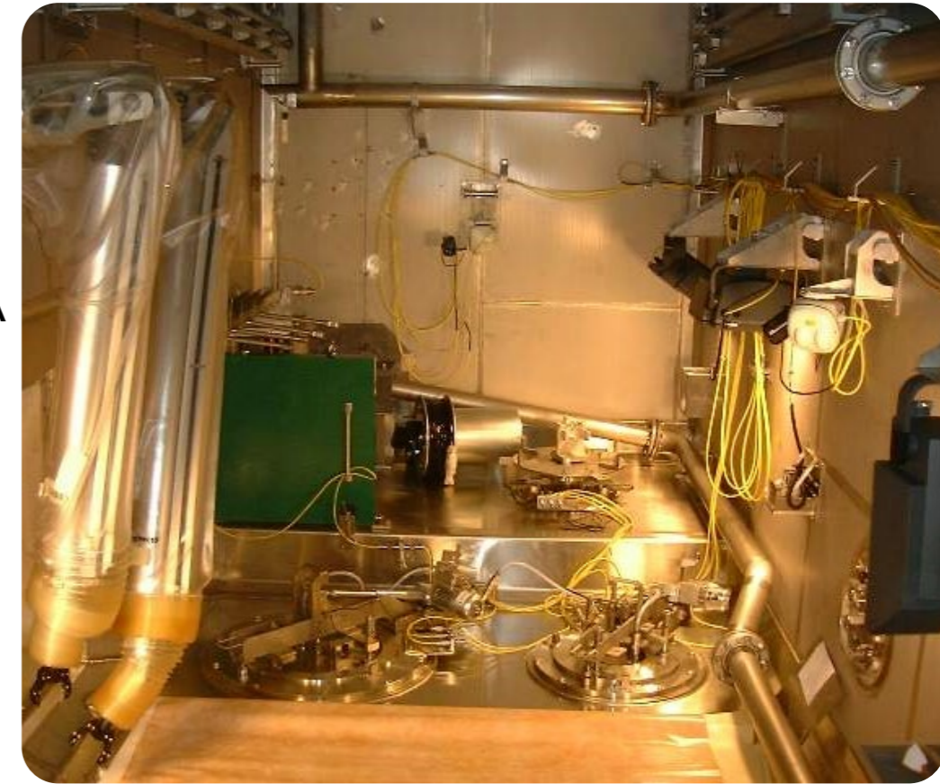
➤ Salle de contrôle
